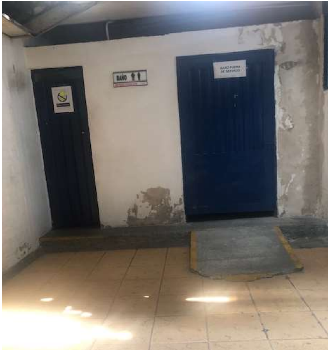
Baño de usuarios y funcionarios ambos con señalización de no funcionamiento
