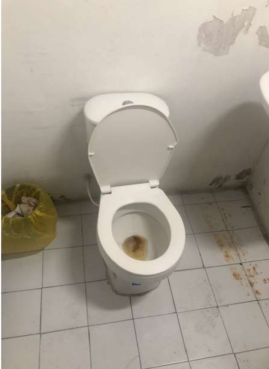
Baño de usuarios y funcionarios sin agua
